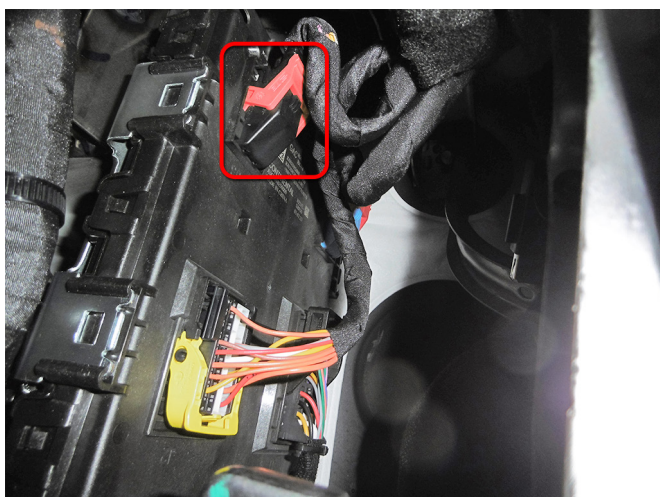
Подключение зажигания 1 осуществляется в черном 52-контактном разъеме блока ВСМ, за левой кик-панелью
